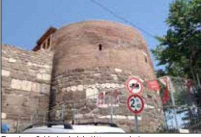
Resim-2 Kuledeki diğer çatlak
