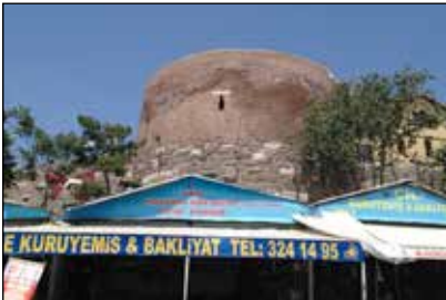
Resim-1 Kuledeki çatlak
