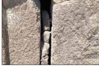
Resim-4 Çatlağın yakın çekimi
