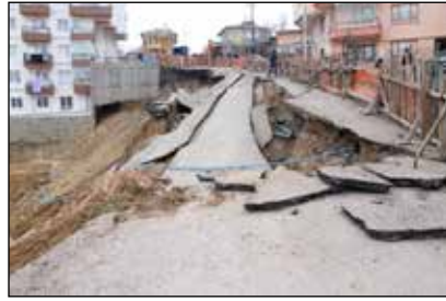
Resim-2 Yamaç kaymasının üst tarafındaki 937nci sokaktan geçen yamaç kayması üst sınırında yaklaşık 2.00 metre kadar düşey hareket sonucu yol kaplamasının yarılması.
